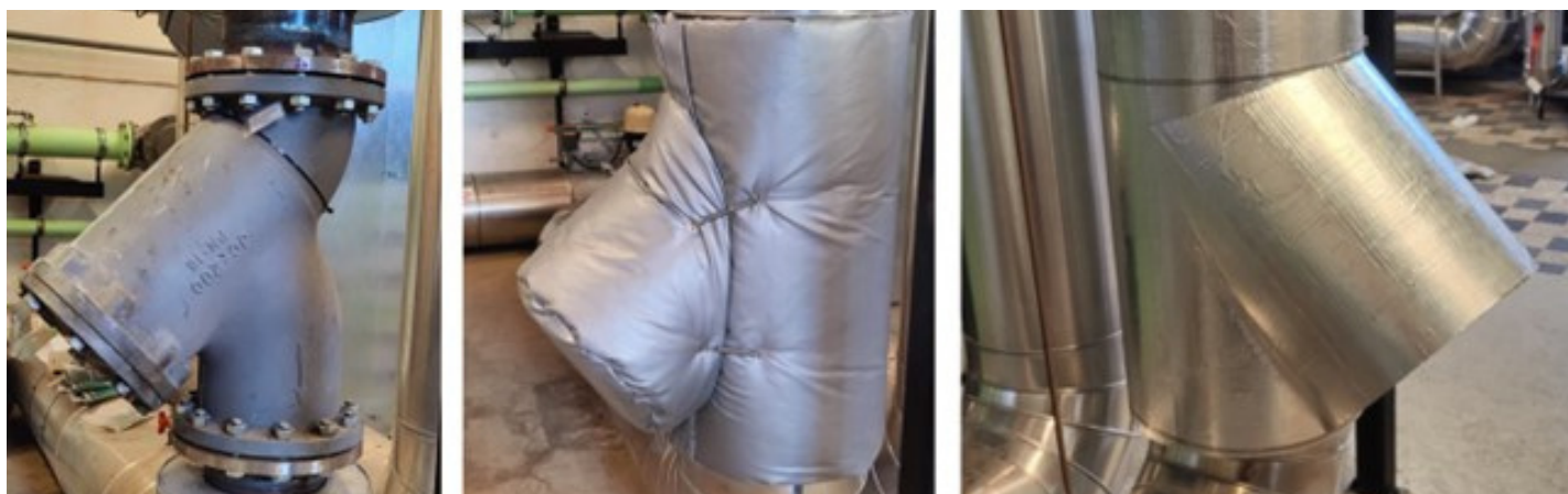
Snavssamler installeret i en fjernvarmepumpestation.
