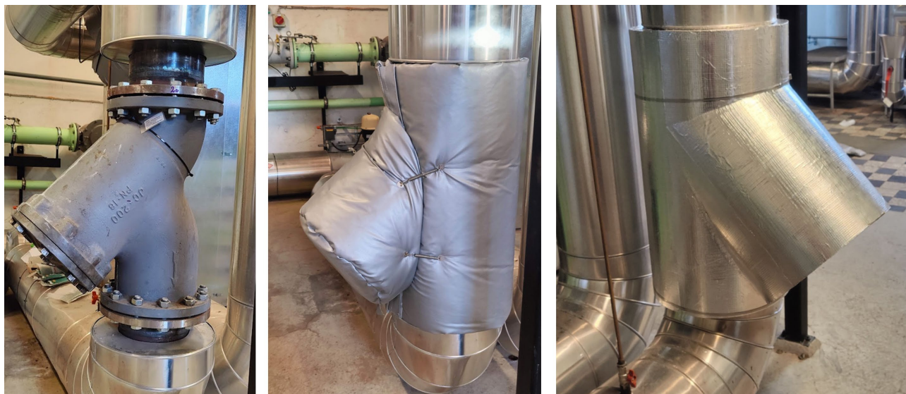
Figur 4: Snavssamler installeret på en fjernvarme pumpestation.
